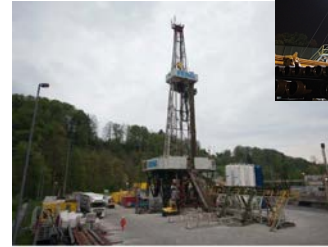
Bildraum des St. Galler Geothermiewerks (Archiv/Parsons)
